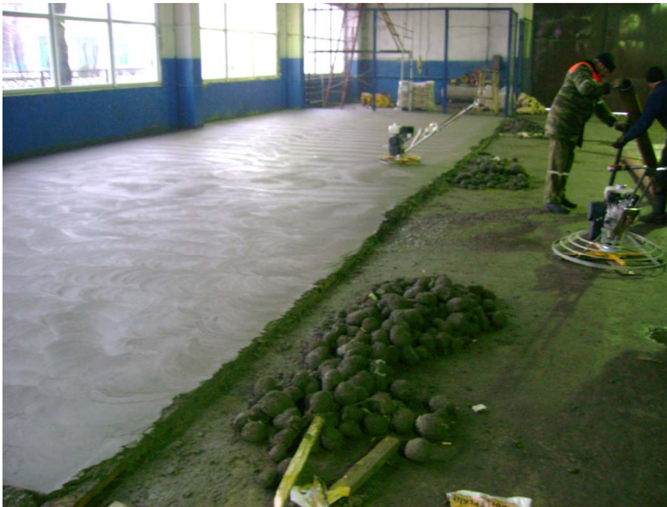
Рисунок 11 Образование «ежеи» из стальной фибры (передний план справа) при устройстве монолитных полов в промышленном здании.
