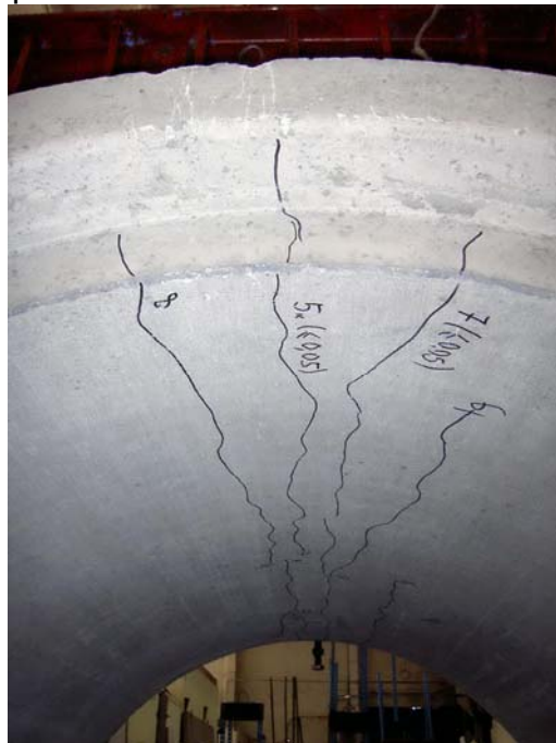
Рисунок 5. Внешний вид трещин в шельге трубы
