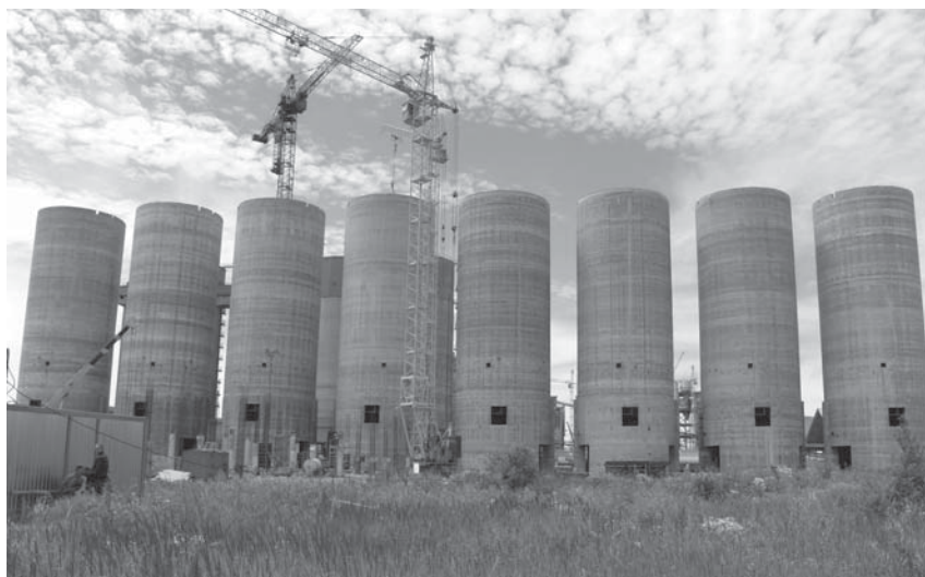
Рисунок 9. Монолитные железобетонные силосы для хранения цемента
