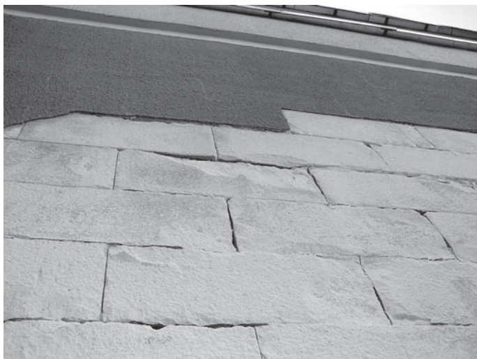
Рисунок 3. Отторжение декоративно-отделочного слоя от поверхности наружной стены после первого отопительного периода
