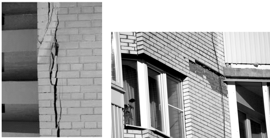
Рисунок 1. Характерные повреждения облицовочного слоя многослойных стен
